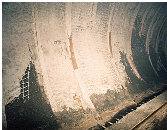
Εικόνα 75. Ανύψωση του (μη αγκυρωμένου) προκατασκευασμένου στοιχείου δαπέδου της σήραγγας Προσαγωγής Μεσοχώρας στους ενδόσιμους σχηματισμούς του Τριαδικού Φλύσχη, λόγω εγκλωβισμένων γεωλογικών τάσεων στην καρδιά του ορεινού όγκου της Πίνδου.
