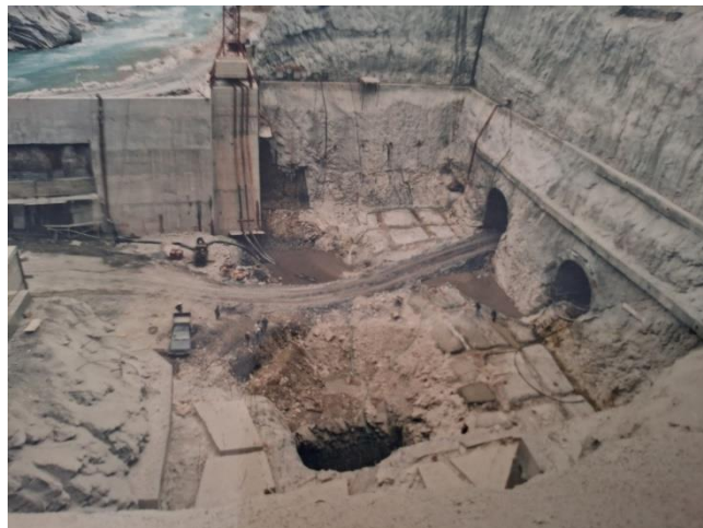
Εικόνα 56. Έξοδος των δύο σηράγγων του αγωγού πτώσης (penstock) (μετά την διακλάδωση) στον σταθμό παραγωγής Μεσοχώρας (στην Γλύστρα).
