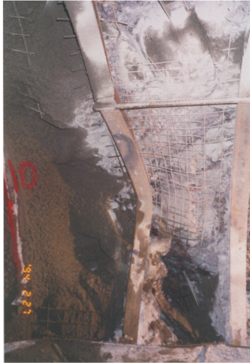
Εικόνα 13: Κατεστραμμένη υποστήριξη σε συνθλίβοντα σχηματισμό
