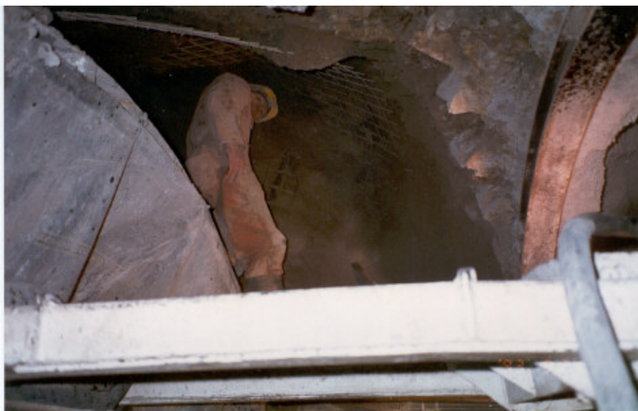
Εικόνα 15: Υπερεκσκαφή σε χαοτικό φλύσχη
